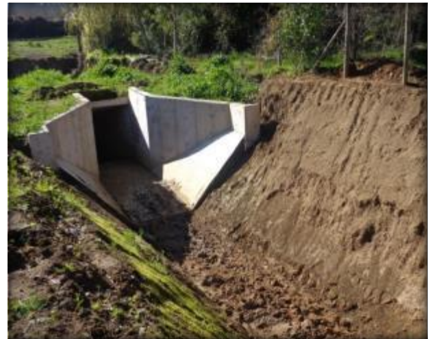
Cámara de salida de Sifón Fortaleza.
